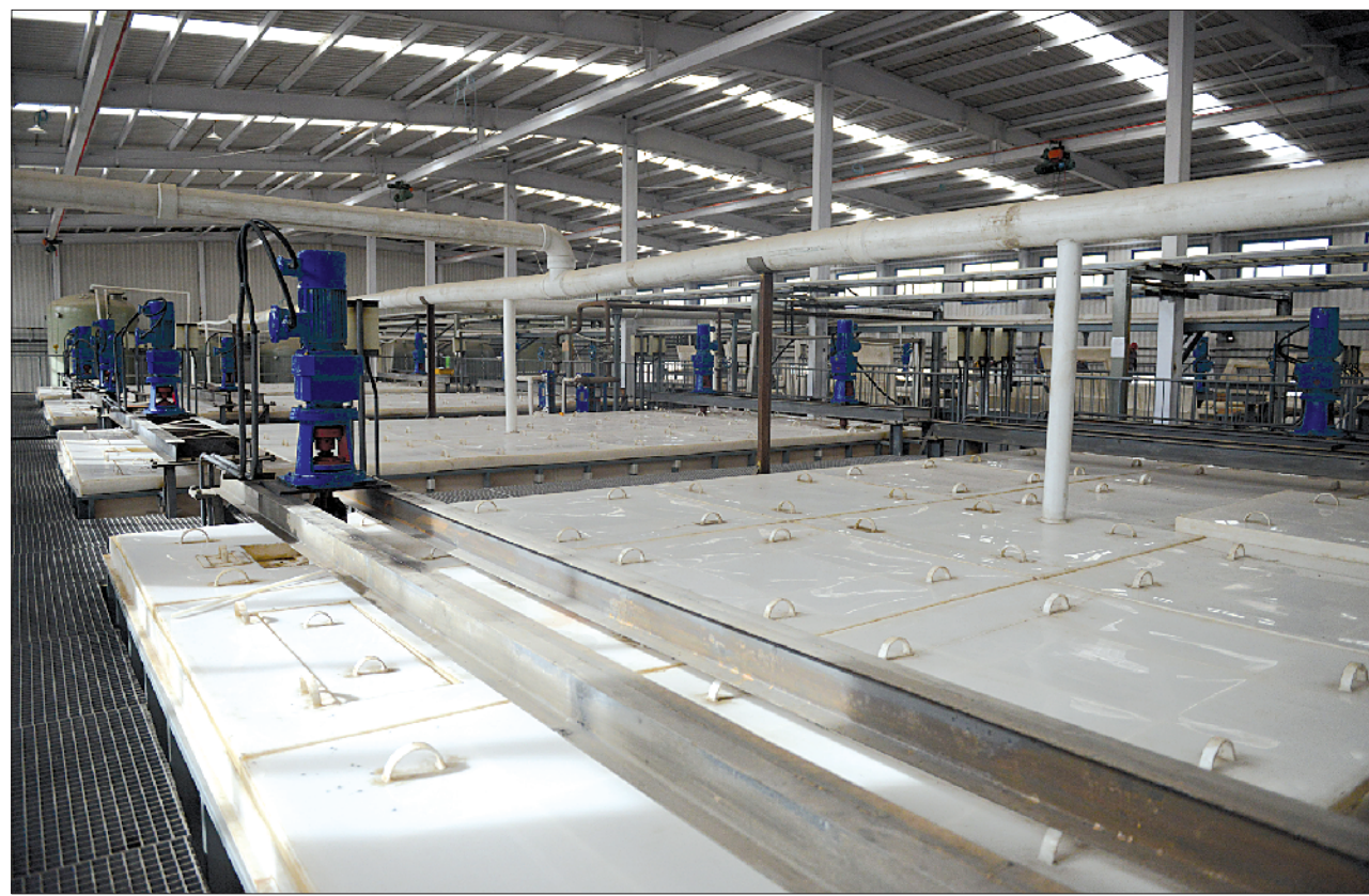
图为兴华锂盐有限公司自主创新的箱式萃取槽。
