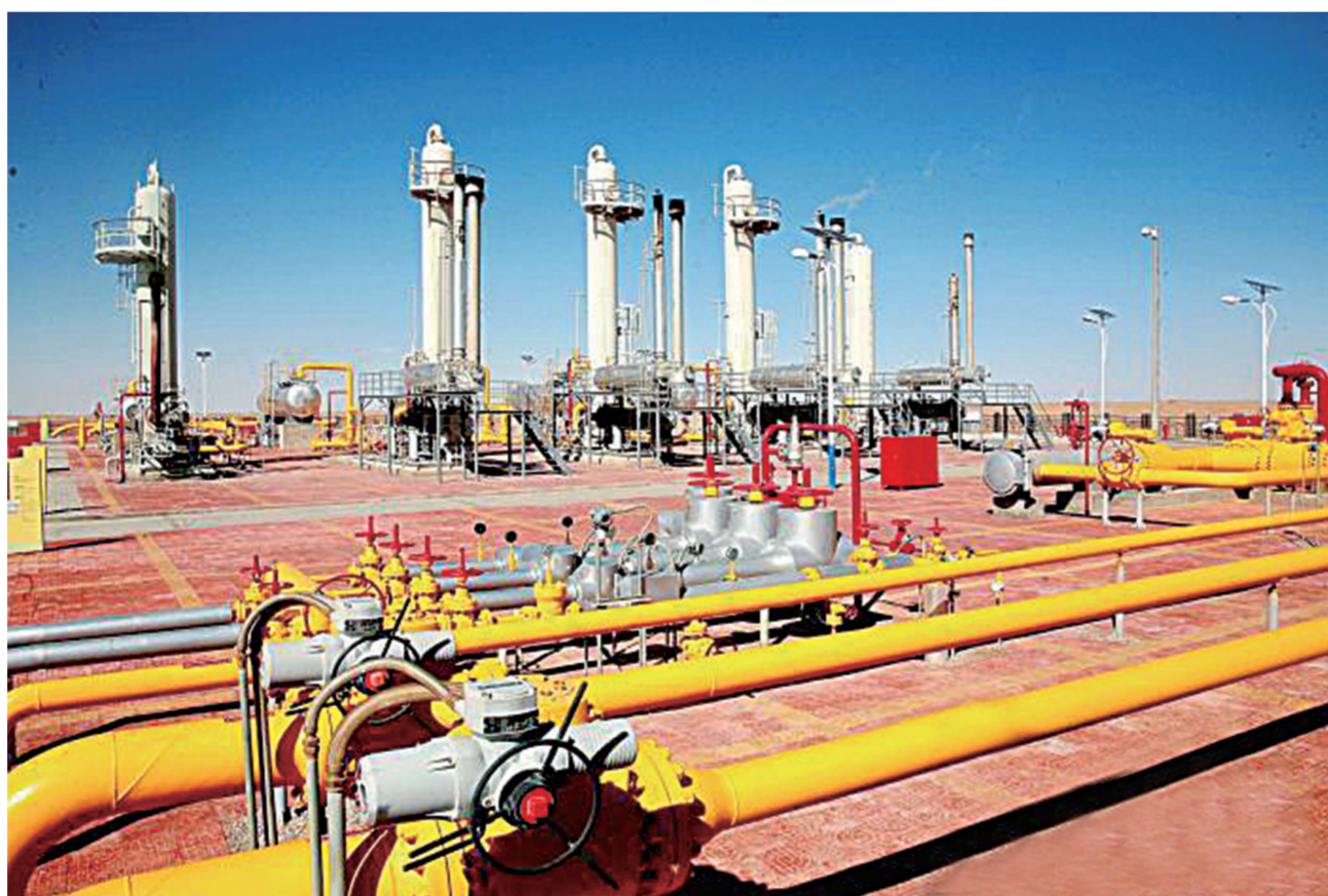
图为涩北气田集气站。
