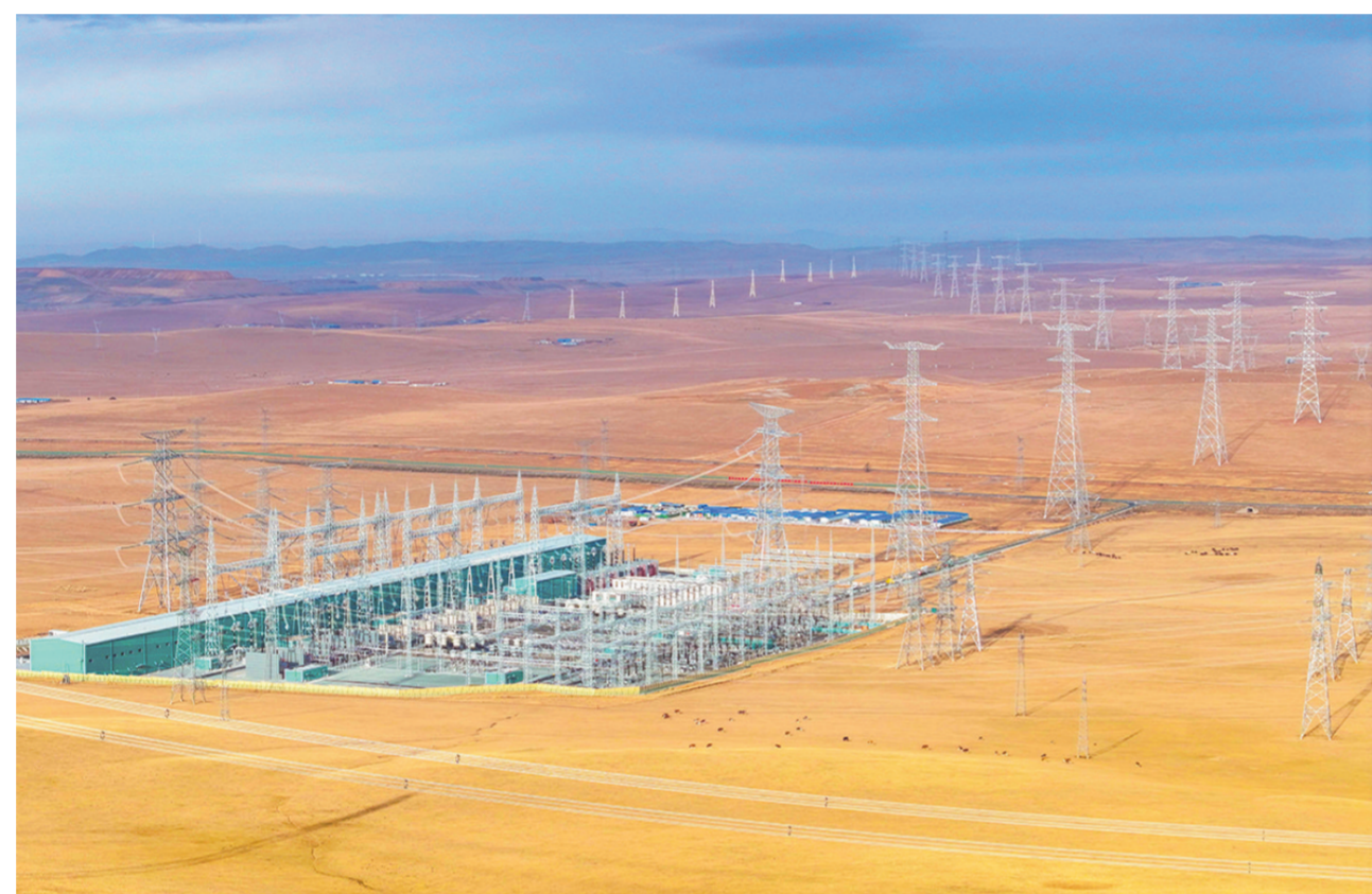
10月31日拍摄的张北——胜利1000千伏特高压交流工程胜利变电站（无人机照片）。
